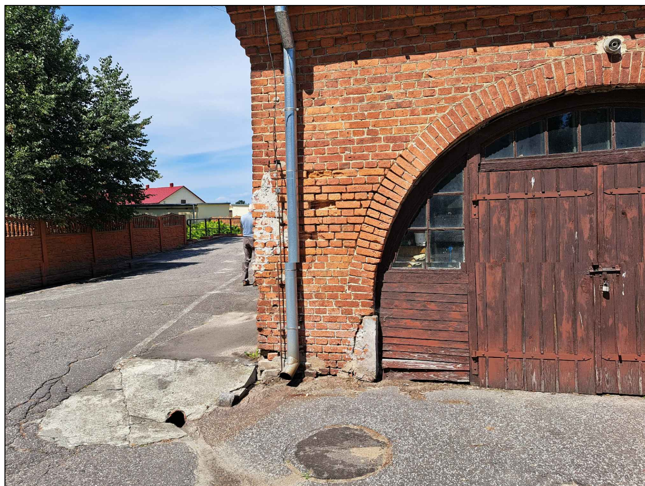
WYMIENIĆ USZKODZONE CEGŁY A SPOINY WYPEŁNIĆ ZAPRAWĄ WAPIENNĄ
